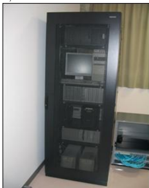
中学校のネットワークサーバー
