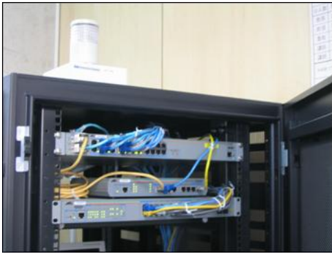
サーバ-連携のサーバラック
